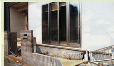
津波により浸水は地面より2mの高さに達しました。
